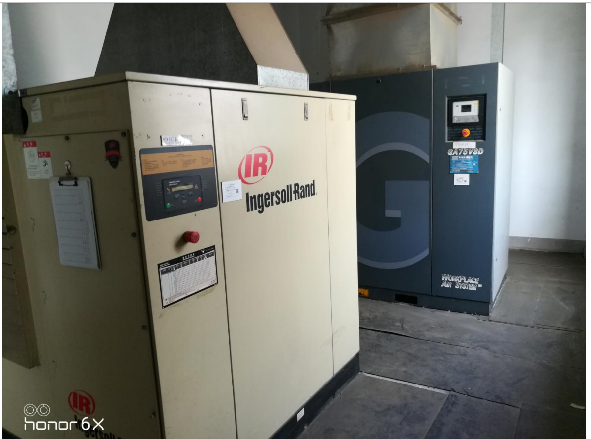
空压机基础减振
